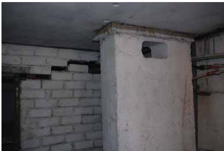
Joonis 3.29 Aluspinnas on vajunud, millega koos ka pinnasele toetatud vahesein ja korstnalõõrid.
