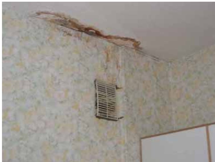
Joonis 3.20 Veeloike katuslael põhjustavad ummistunud sadevee äravoolu lehtrid ja ebapiisavad kalded (ülal). Loigud korstnate juures on potentsiaalseks lekkekohaks. All: katuse läbijooksu tagajärg korstna juures.
