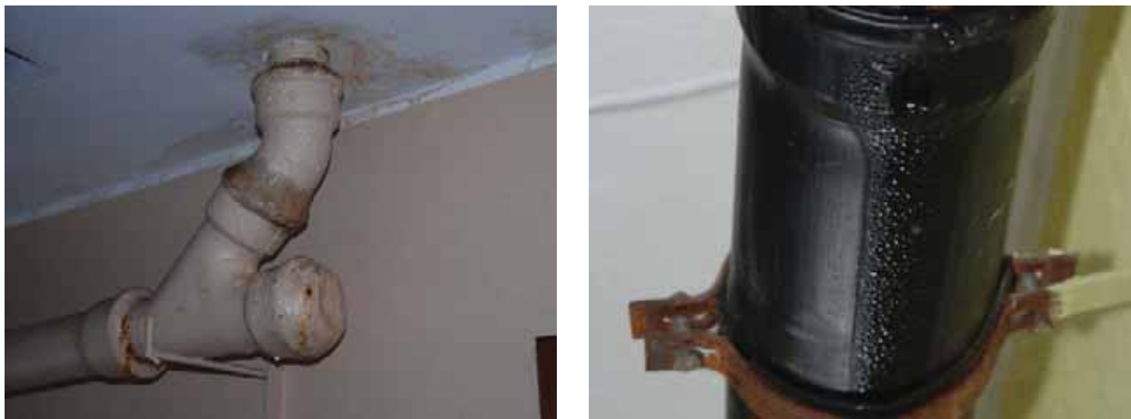
Joonis 15.4 Lekkiv (vasakul) ja kondensaadiga kaetud (paremal) kanalisatsioonitoru.
