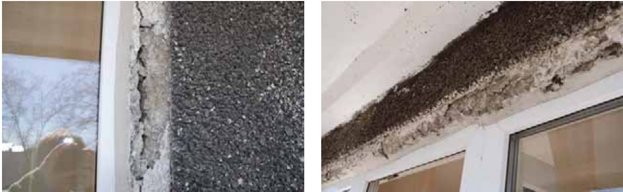
Joonis 5.1 1962. aastal ehitatud seeria I-464 elamu välisfassaad on hakanud lagunema
