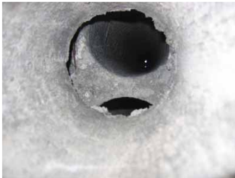
Joonis 13.4 Ventilatsioonikanalite paneelid ei ole kohakuti: erinevate korterite õhuvool on takistatud ja õhuvoolud segunevad
